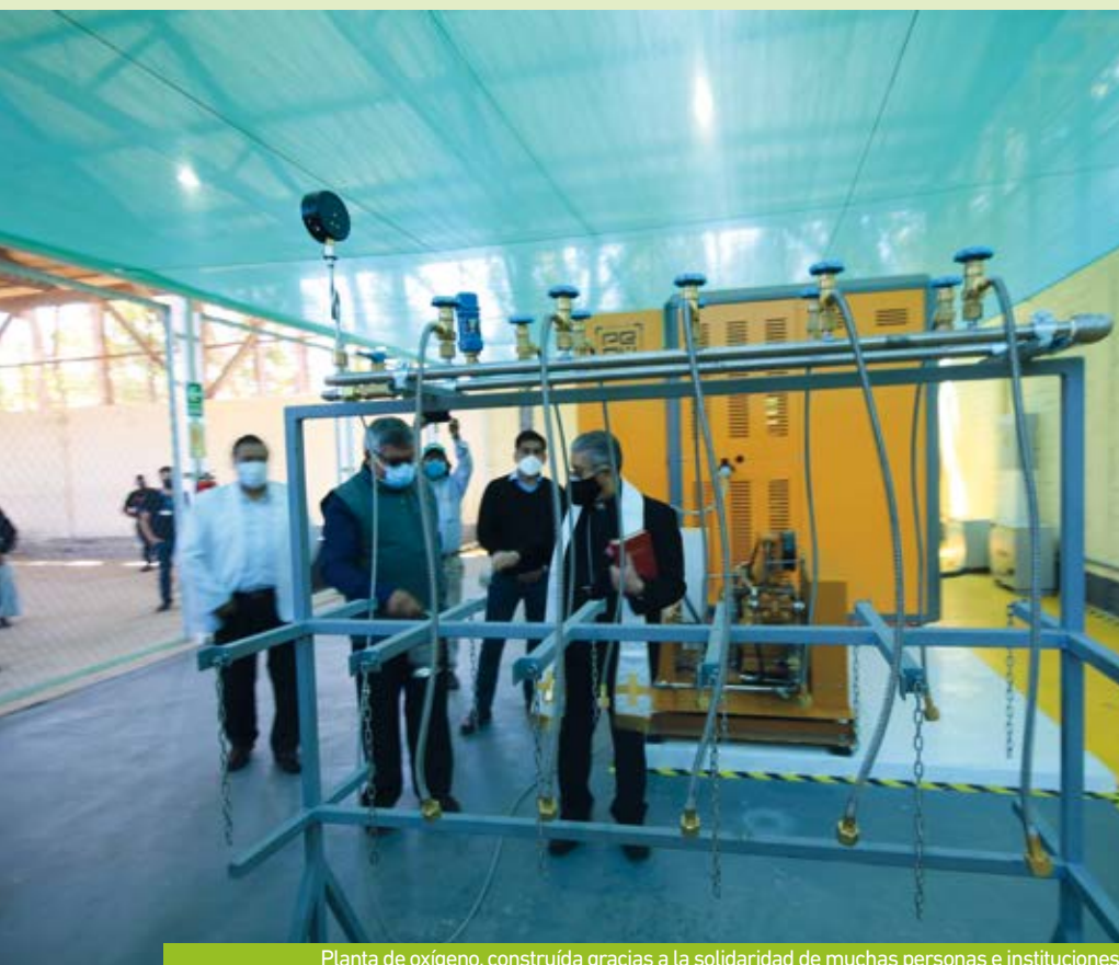
Planta de oxígeno, construída gracias a la solidaridad de muchas personas e instituciones
